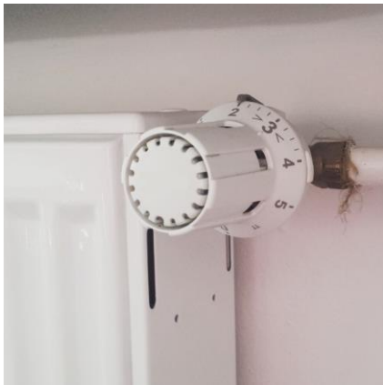
Thermostatventil auf Stufe zwei.
