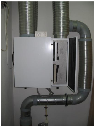
Lüftungsgerät mit zusätzlicher Wärmerückgewinnung Foto: VZ RLP/Bernhard Andre
