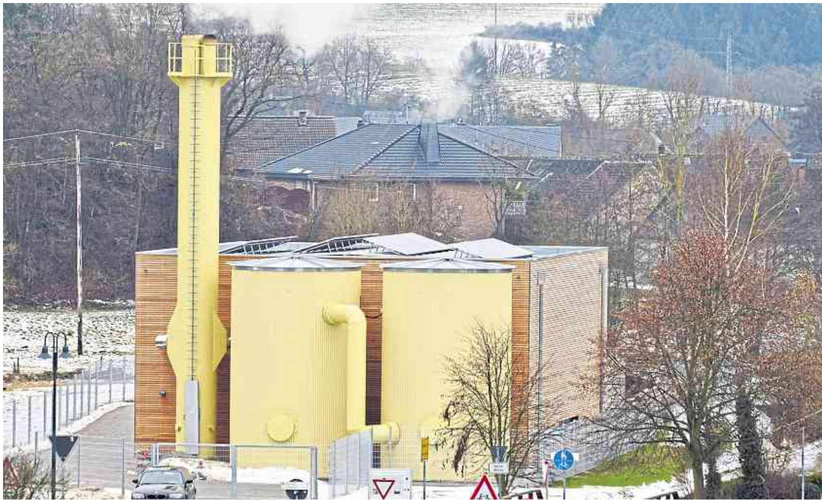
Zwei Holzhackschnitzelkessel und eine Solarthermieanlage erzeugen die Wärme für die Gemeinden Neuerkirch und Külz.
