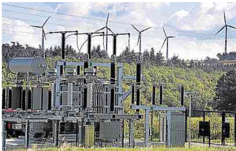
Für die stetig wachsende Zahl neuer Windkraftanlagen müssen zusätzliche Umspannwerke gebaut werden, die den Strom ins Netz bringen.
